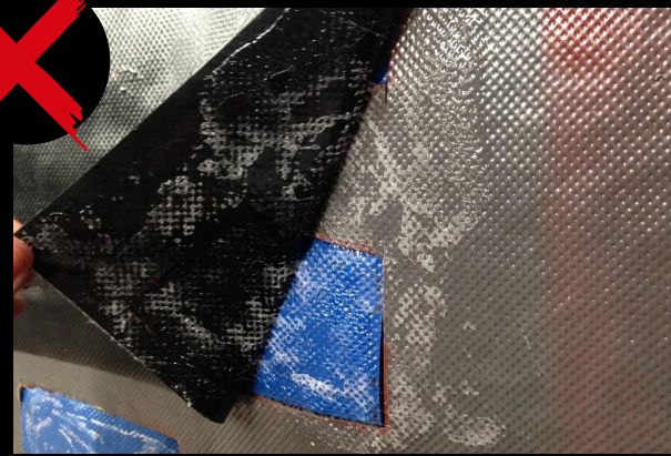
Lona pegada como base que se desprende rápidamente
